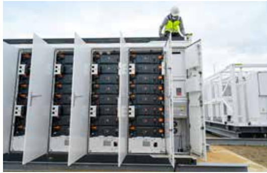
Neben einem bestehenden 12-MW-Speicher befindet sich ein weiterer 20-MW-Speicher im Aufbau.
